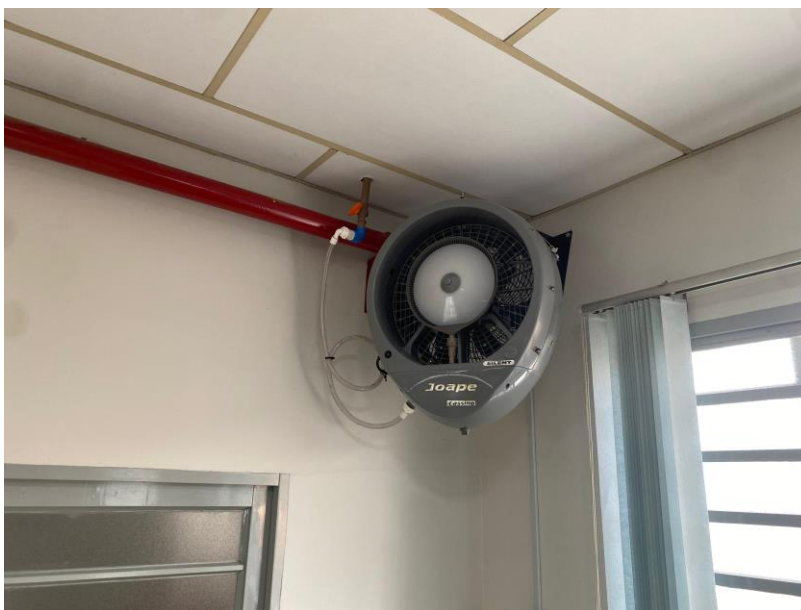
Figura 2 - Climatizador Interno - Berçário
