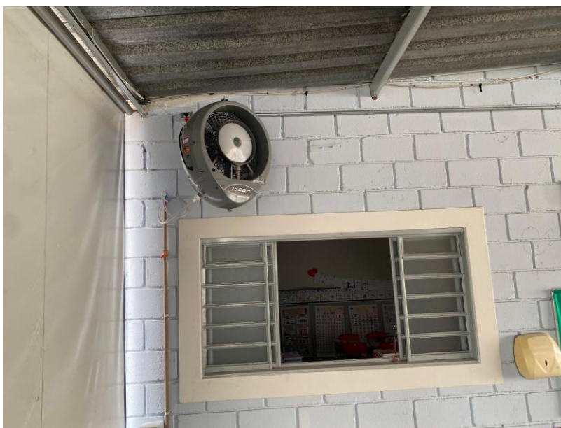
Figura 1- Climatizador Externo - Pátio
